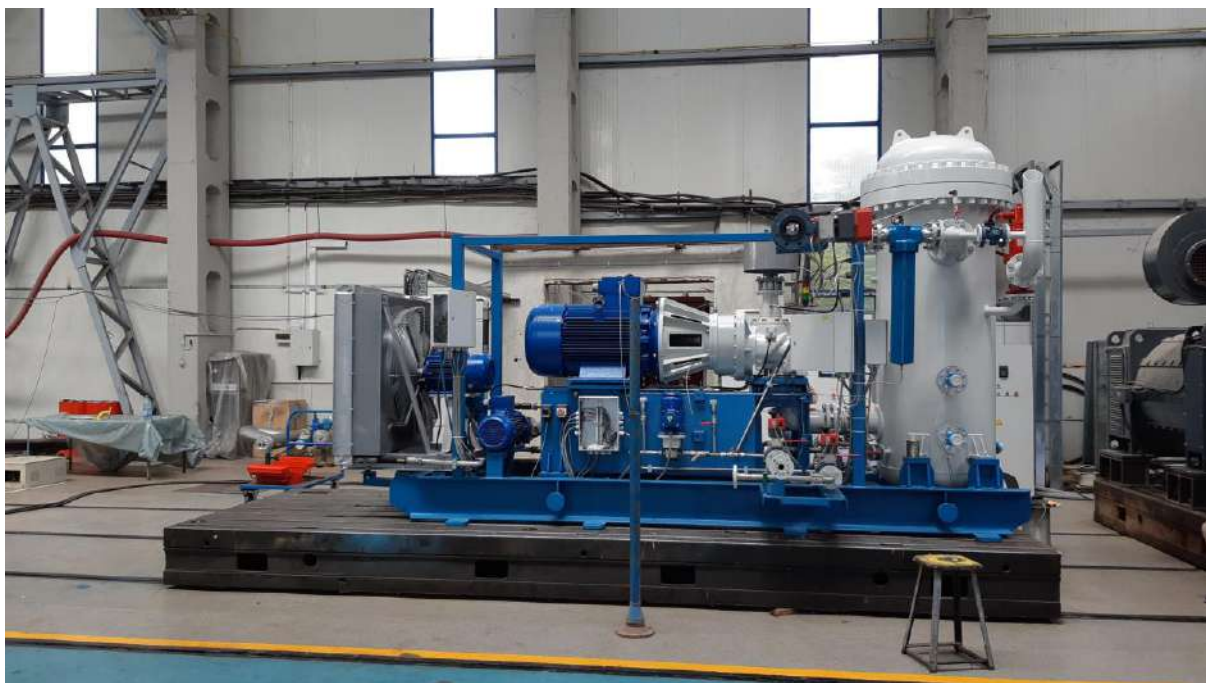
Fig. 3. Instalația de comprimare cu automatizare
