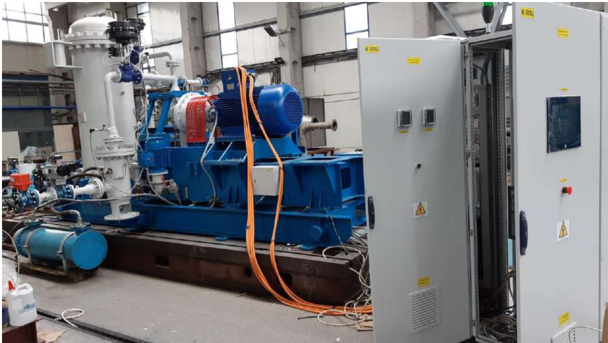
Fig. 4. Echipamentul de detentă cu dulapurile SCADA
