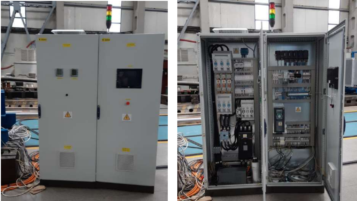
Fig. 7. Dulapurile de automatizare ale expanderului: a) cu ușile închise și b) echipamentele interioare
